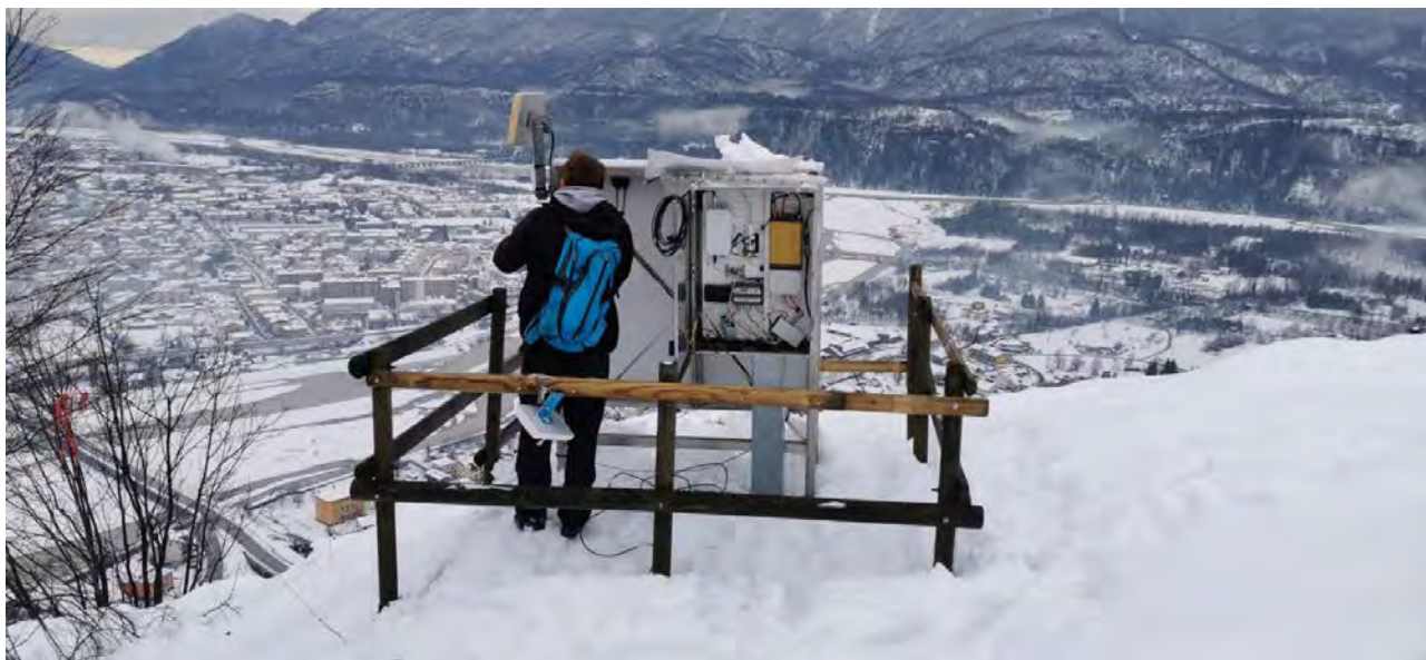
Operazioni di manutenzione su una delle stazioni della rete di monitoraggio sismico e geodetico (SMINO).
